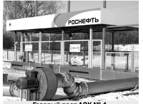
Газовый пост АЗК № 4.
