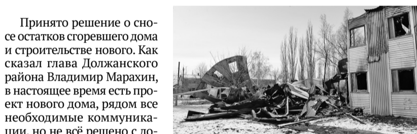
Всё, что осталось от 16-квартирного дома
