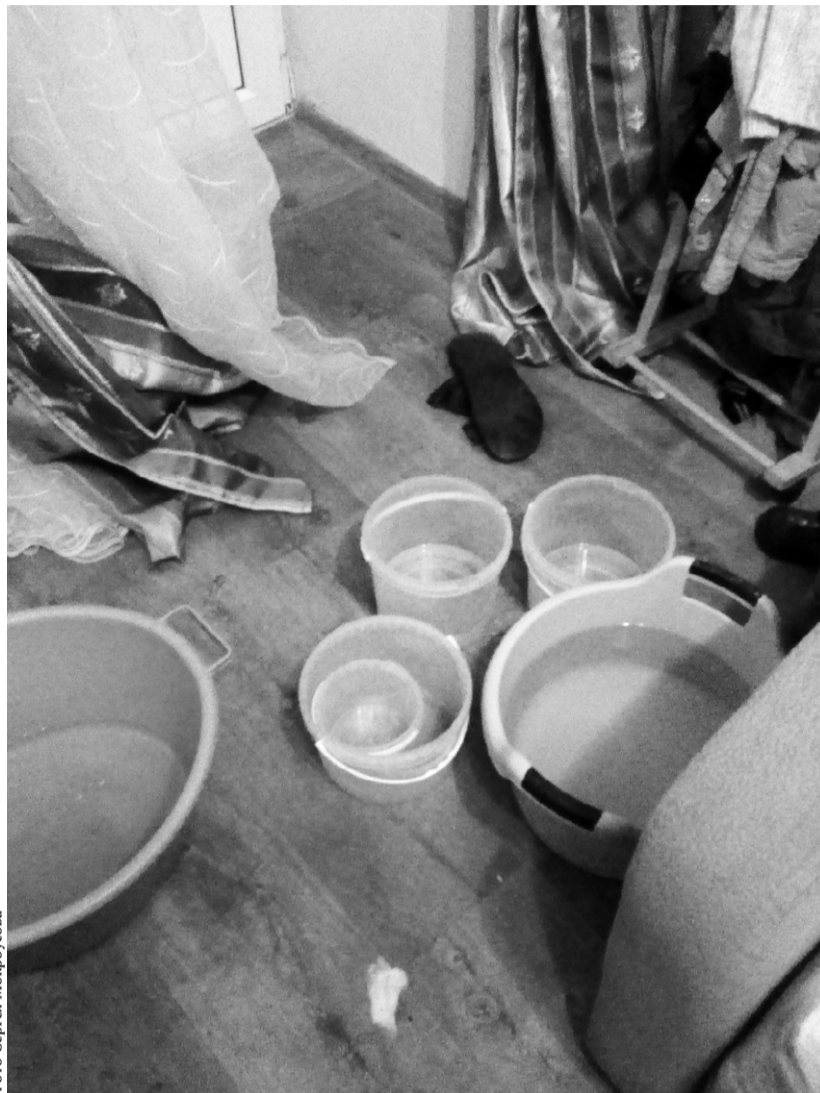
Зачастую латочный ремонт для старых кровель бесполезен — поможет только капитальный
