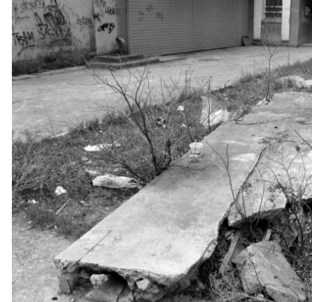
Бетонная плита у филиала центра детского технического творчества.
