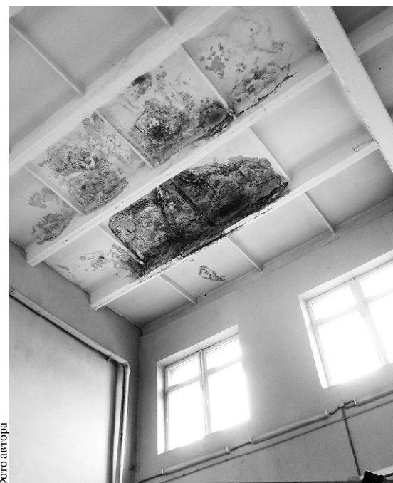
Крыша выставочного зала — в плачевном состоянии
