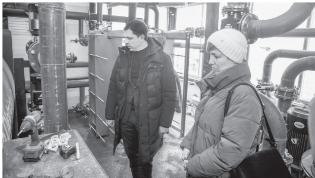
Новая котельная в селе Коротыш
