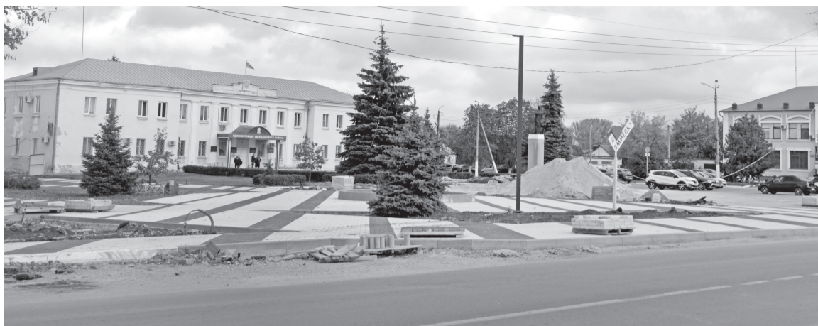
Работы на объекте «Связующая нить» идут полным ходом и должны завершиться в конце октября
