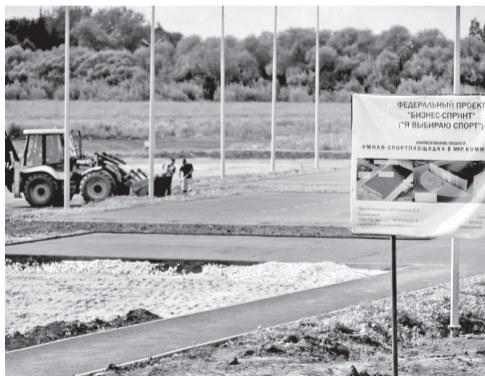
На «умной» спортплощадке скоро появится новое оборудование
